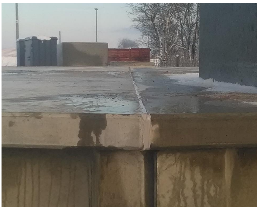
Figur 11 viser fuget samling mellem to A-dæk.
